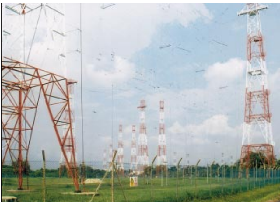
Vorhangantennen auf dem Gelände der Relaisstation
